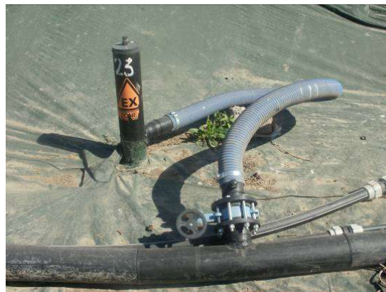
Puits de captage du Biogaz sur W2
