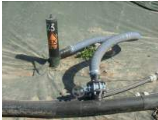
Puits de captage du Biogaz sur W2
