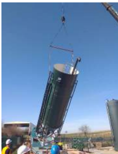
Cuve à charbons actifs
