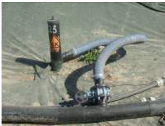
Puits de captage du Biogaz sur W2
