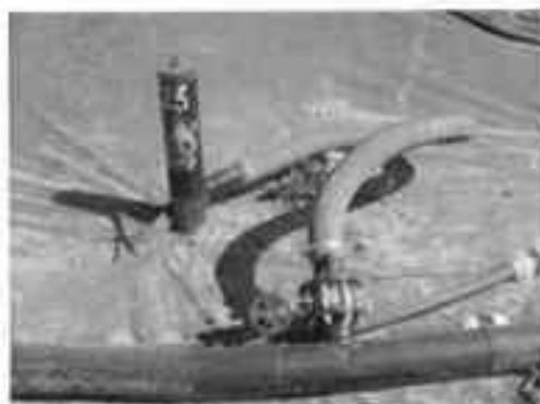
Puits de captage du Biogaz au W2
