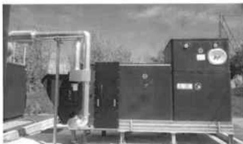
Photo de la station d'évaporation :
